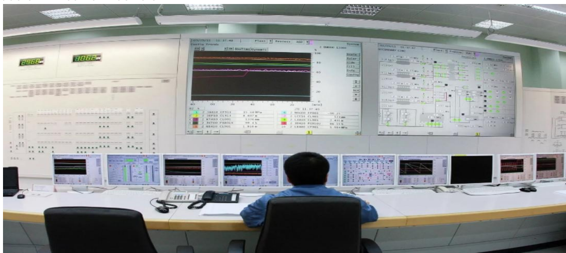
Trabalhador em sala de controle monitora o reator nuclear da Unidade 2 da usina nuclear de Tianwan, em Lianyungang, na província de Jiangsu, leste da China Foto: AP Photo
